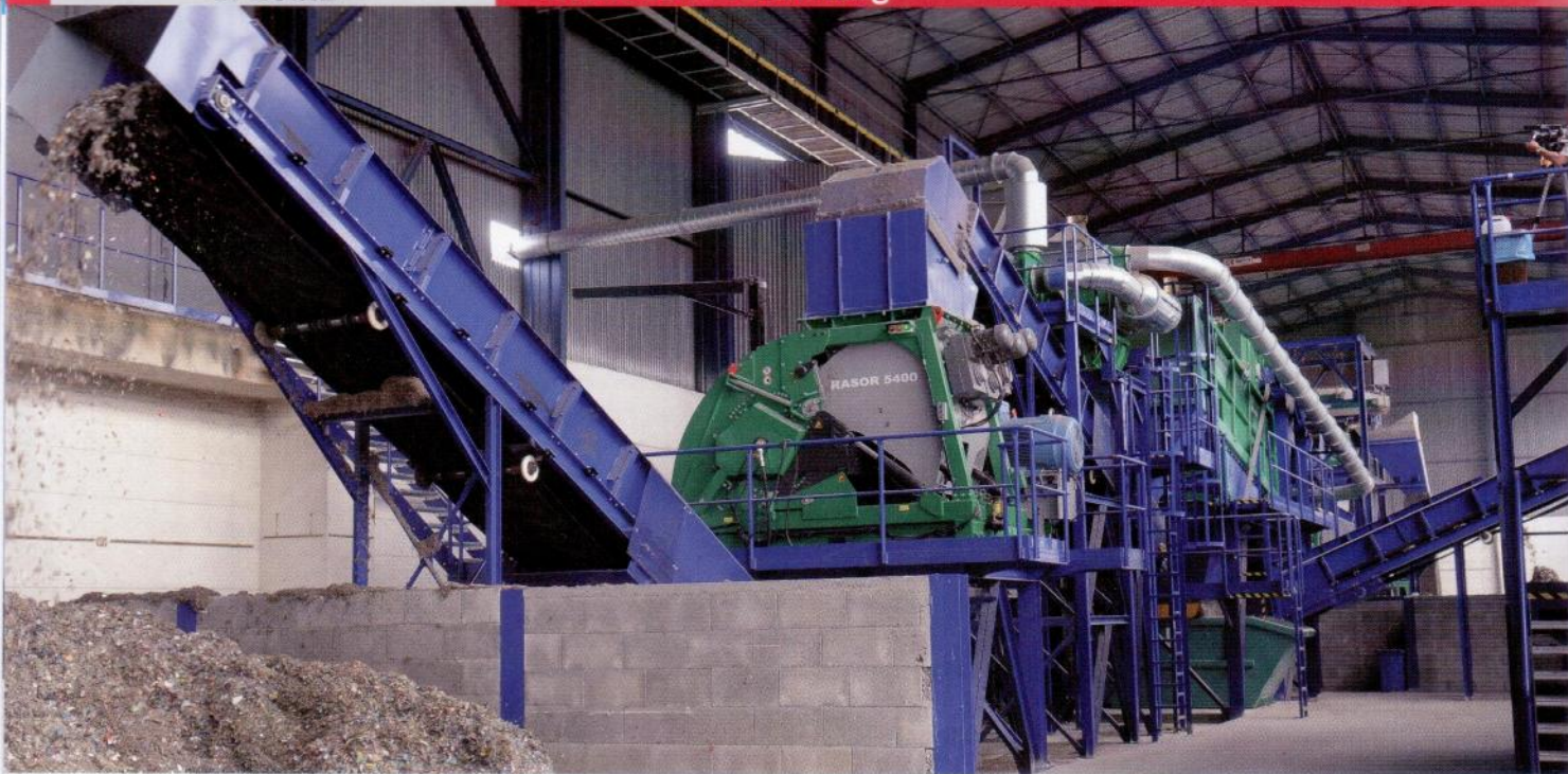
Maschinenlinie der Aufbereitungsanlage für Ersatzbrennstoffe in Žilina mit dem produzierten Premium-EBS
